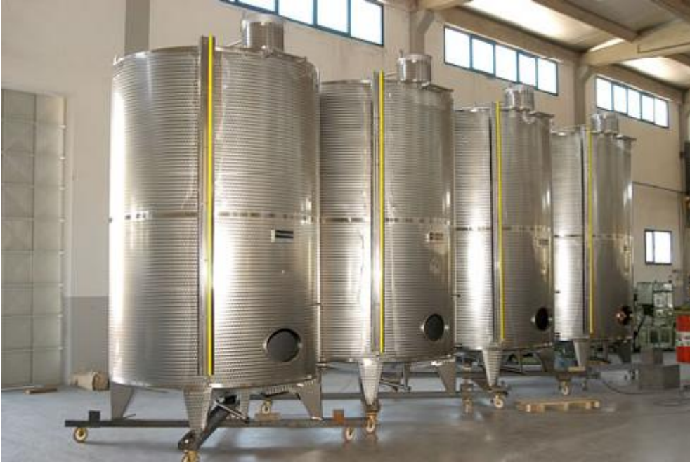
Şekil 1.1. Zeytinyağı depolamada kullanılan çelik tank örnekleri (12).
